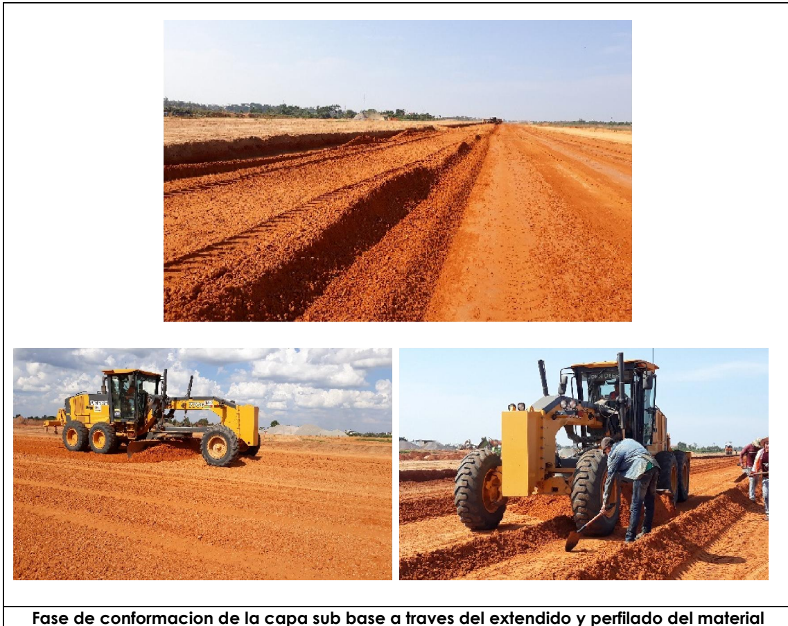
ILUSTRACIÓN 23. FASE DE CONFORMACION DE LA CAPA SUB BASE A TRAVES DEL PROSESAMIENTO Y HOMOGENIZADO DEL MATERIAL
