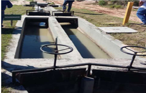
Desarenador de flujo horizontal
