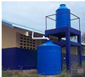
Figura 11: Tanque de Agua
