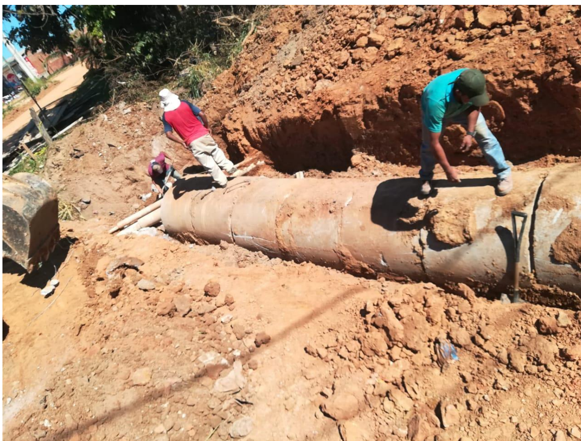
Figura 45. Tubos de hormigón armado deteriorados
