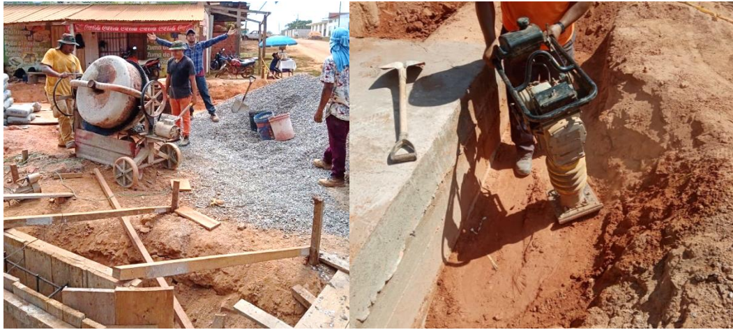
Figura 38. Equipos utilizados para las actividades que conforman el drenaje pluvial Fuente: Elaboración propia
