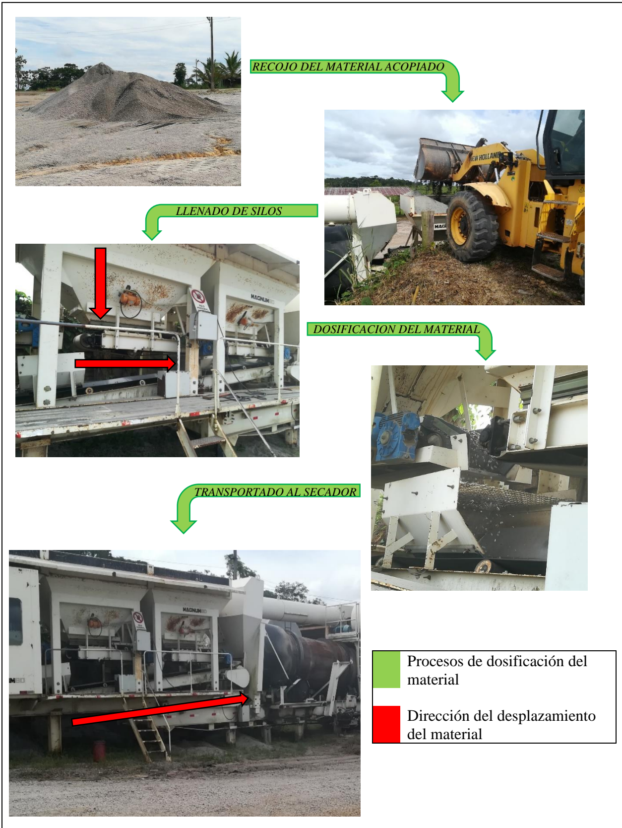
Figura 104. Dosificación de áridos en la planta de asfalto
