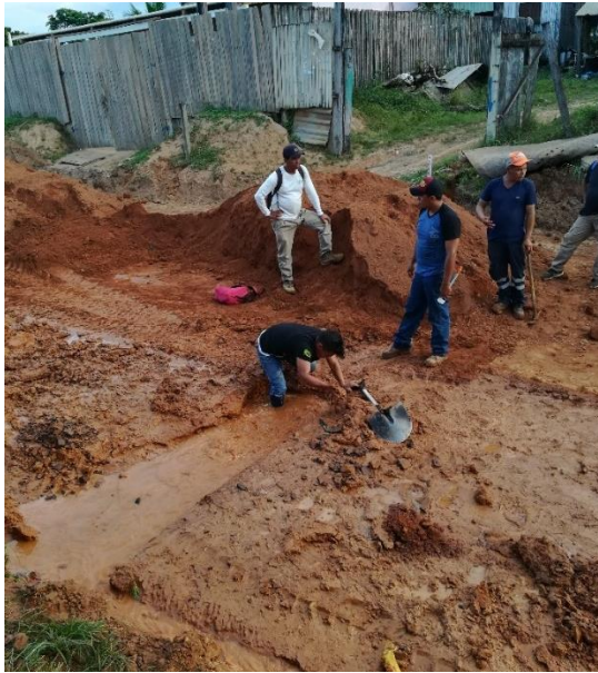
Figura 31. Fuga de agua de acometida de agua potable
