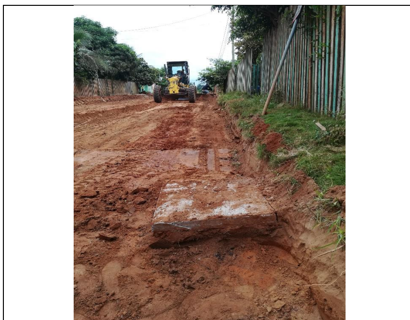
Figura 17. Cámara de inspección invadiendo plataforma
