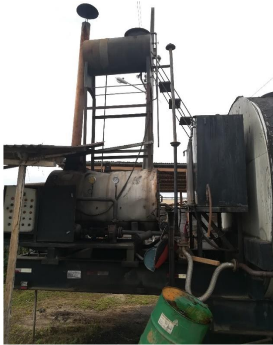
Figura 110. Caldera del termotanque de asfalto TEREX
