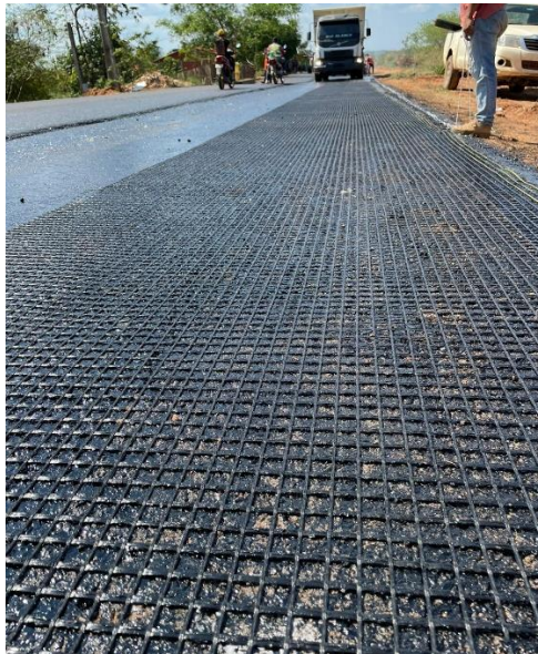
Figura 78. Geomalla de fibra de vidrio tendida en cumplimiento al proyecto Fuente: Elaboración propia
