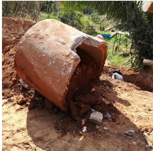
Figura 36. Tubo de hormigón armado extraído de un drenaje anterior Fuente: Elaboración propia
