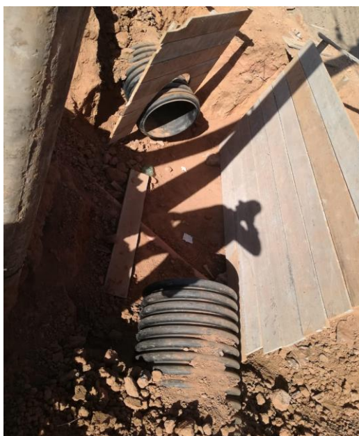
Figura 43. Tubos Pead de 24” colocados para el desvío de aguas pluviales Fuente: Elaboración propia
