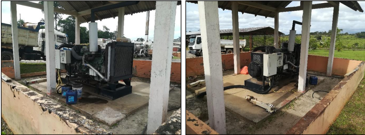
Figura 103. Generador de electricidad para la planta de asfalto
