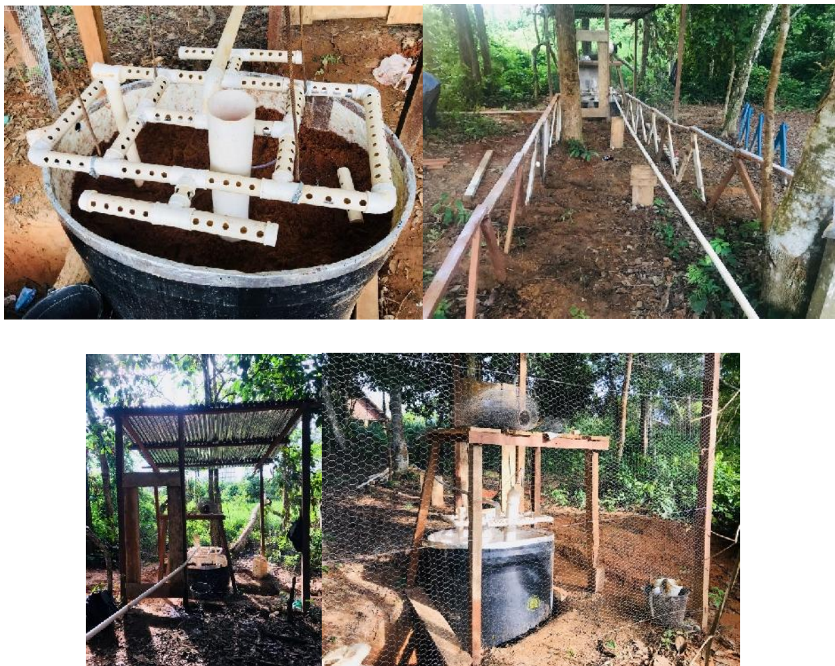
Figura 3.16. Planta piloto de lombrifiltro terminada
