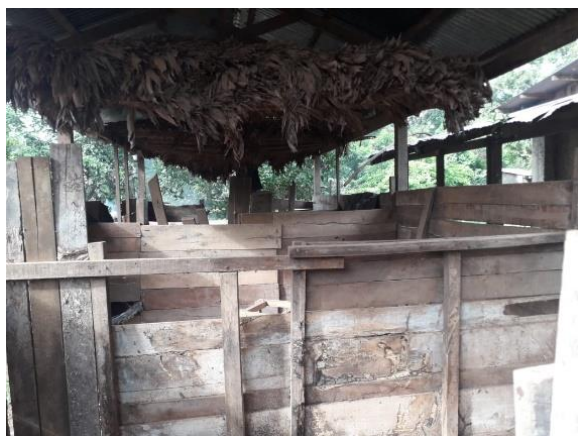
7.1. Foto Instalaciones de almacenamiento de silo
