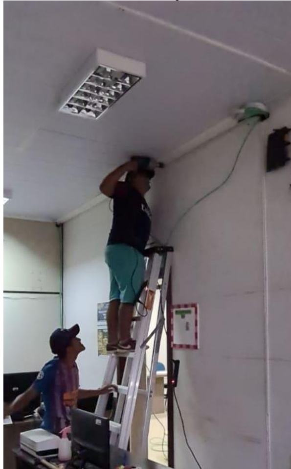
Figura 15 Cableado en oficinas de la torre "A" y "B" Fuente: Elaboración Propia
