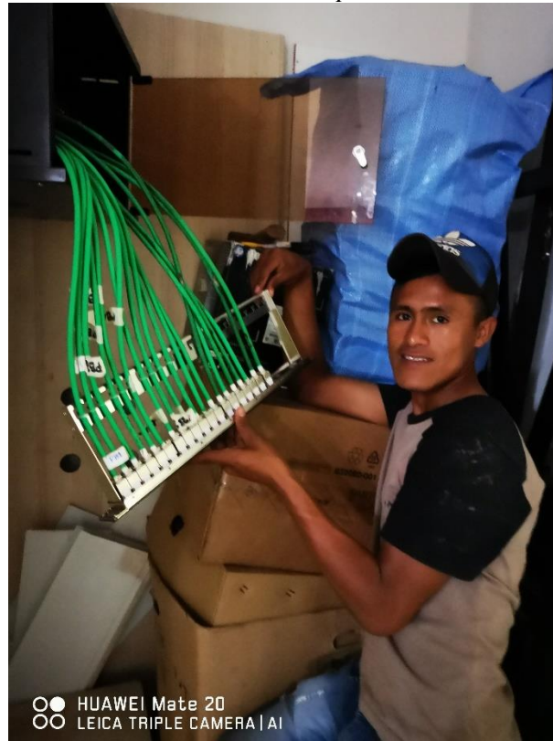
Figura 14 Un cableado en orden y bajo normas de las redes híbridas un Patch Panel de 24 Puerto Fuente: Elaboración Propia
