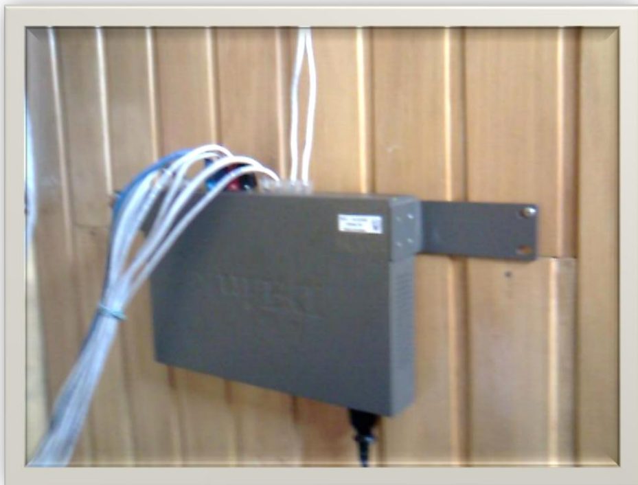
Figura 2: Fotografía de los Switch Central Ubicado en la Unidad de Redes Fuente: Elaboración Propia.
