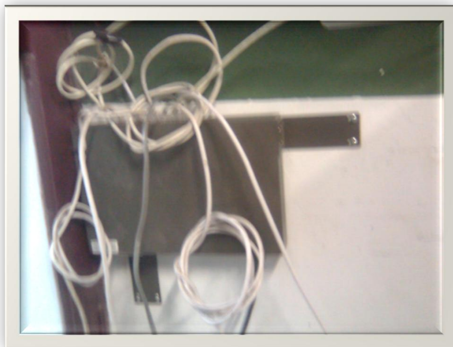
Figura 3: Fotografía de ejemplo que los Switch están empotrado en la pared Fuente: Elaboración Propia.
