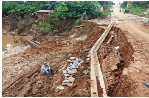
Figura 3.5 Daños Ocasionados Por La Inundación
