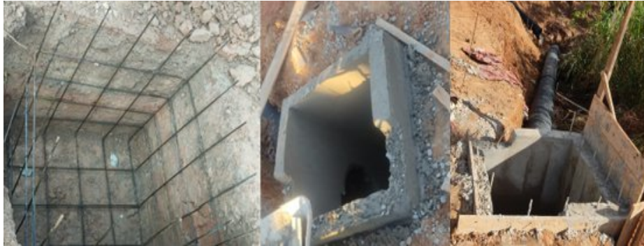
Figura 2.10 Cámaras de Inspección
