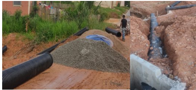
Figura 2.16 Tubos de PVC 400 mm Corrugado
