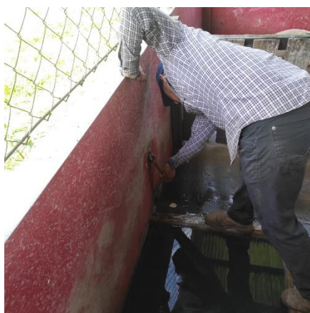
FOTO N.º 7 MANTENIMIENTO DE BEBEDEROS
