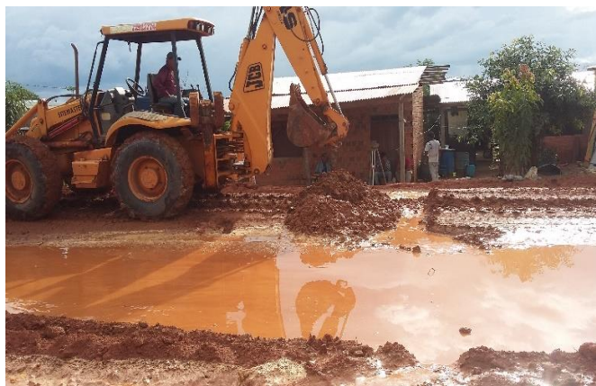
Figura 2.43 Acumulación de agua pluvial
