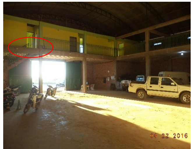
Foto 18. Parte de la infraestructura sin baranda riesgo ergonómico
