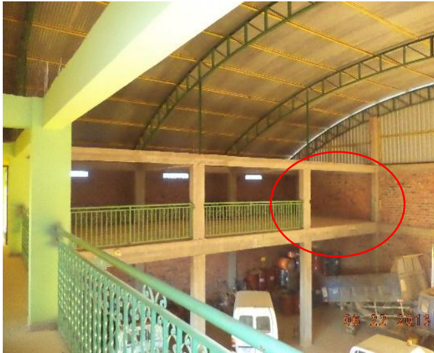
Foto 17. Parte de la infraestructura sin baranda riesgo ergonómico
