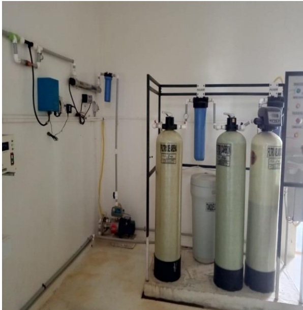
Figura 4. Filtros procesadores fuente: Foto extraído de la empresa agua Shalom
