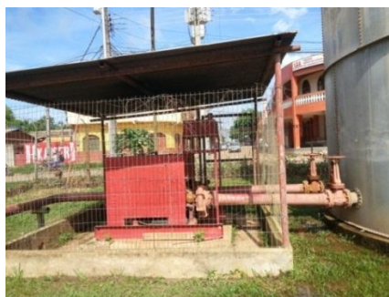
FIGURA N°11: Bomba a gasolina de agua y espuma contra incendios
