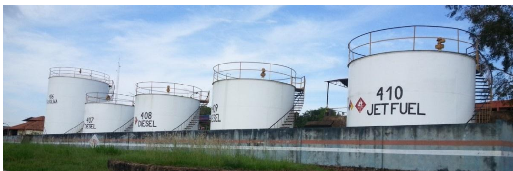
FIGURA N°7: Tanques de almacenamiento
