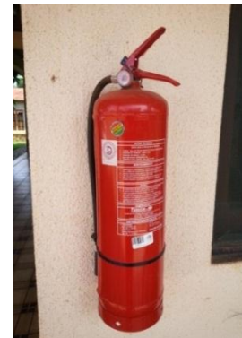
FIGURA N°14: Falta señalización de extintor
