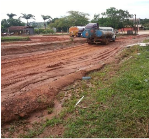
FIGURA N°19: Rutas de salida sin señalizaciones y circulación de tierra.
