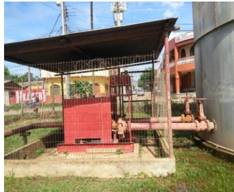
FIGURA N°13: Falta señalización en la bomba de agua y espuma
