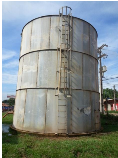
FIGURA N°9: Tanque de agua contra incendios de 110.000 lt.
