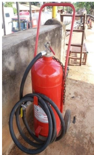
FIGURA N°6: Extintor Rodante de 50 lb P.Q.S-ABC
