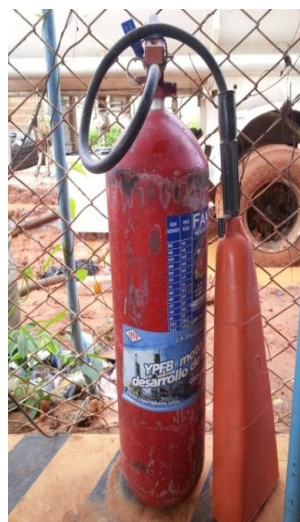
FIGURA N°5: Extintor Portátil de 6 lb de CO_2
