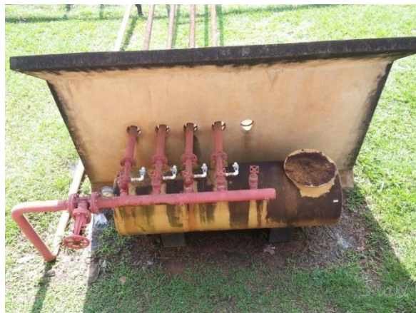
FIGURA N°10: Tanque de espuma contra incendio de 500 lt.
