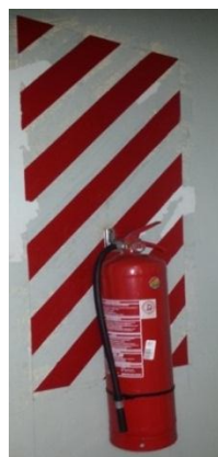
FIGURA N°15: Altura de la señalización incorrecta
