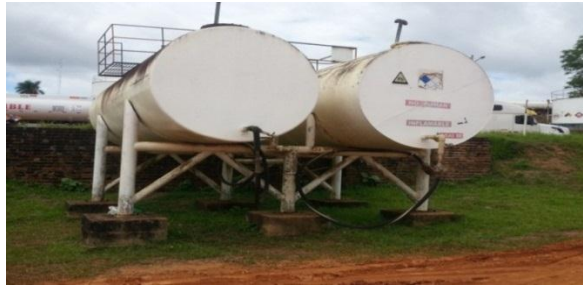
FIGURA N°8: Tanques de almacenamiento de av gas/querosén
