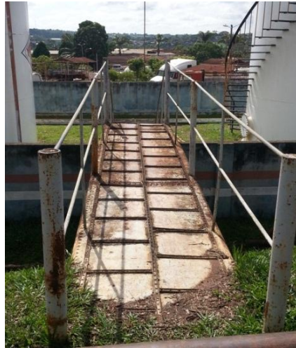
FIGURA N°23: no existe señalización en las vías de circulación
