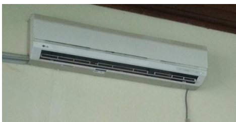
FIGURA N°72. Ventilación Mecánica en la Planta Zona Comercial Cobija Y.P.F.B.
