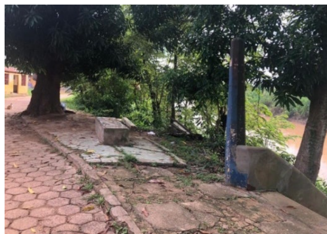
Fotografía N° 2: Escalinata al Rio Acre.
