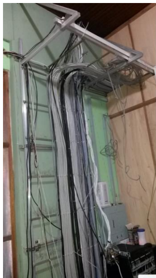
Ilustración 21 Entrada del enlace de Fibra Óptica – Elaboración propia
