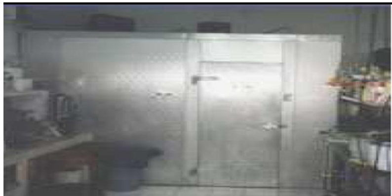
Figura 42 sistema frigorífico Fuente importadora APYTEK S.A
