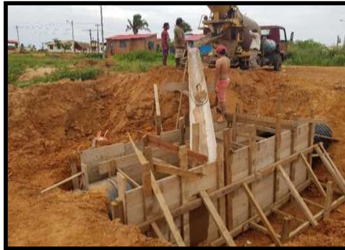
Figura 28. Vaciado de hormigón armado para la unión entre tubos Fuente: Elaboración propia
