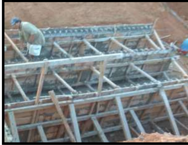
Figura 25. Encofrado y apuntalado de obras de drenaje para alcantarilla Fuente: Elaboración propia
