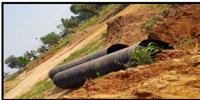
Figura 21. Tubos de PVC 1000 mm corrugado Fuente: Elaboración Propia
