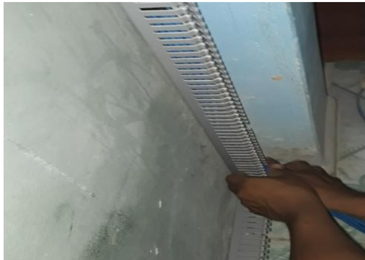
Figura 3.31 Organización del cableado Fuente: Elaboración propia
