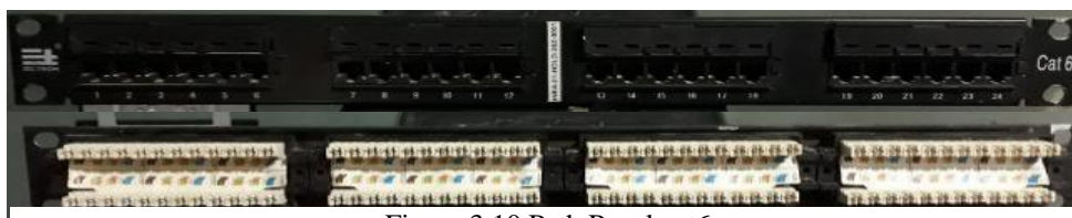
Figura 3.10 Path Panel cat6 Fuente: elaboración propia
