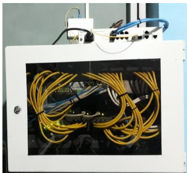
Figura 3.35 Instalación final del rack de distribución Fuente: Elaboración propia
