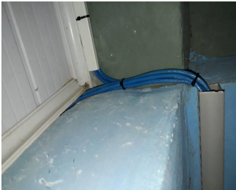
Figura 3.26 Cableado horizontal con espacio para un futuro crecimiento de la red Fuente: Elaboración propia
