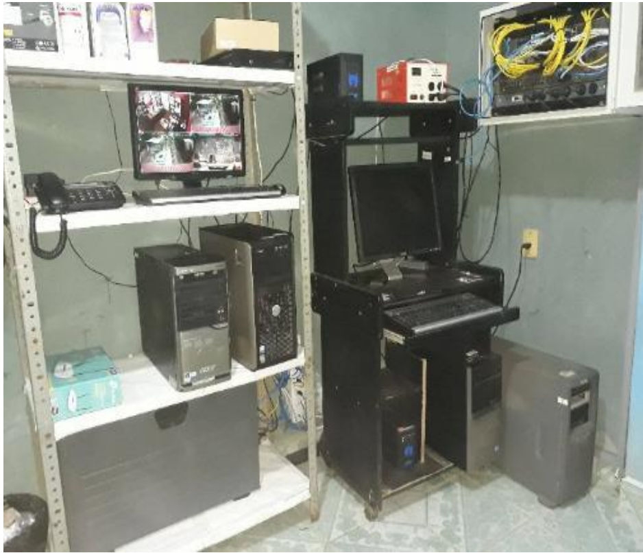
Figura 3.28 Sala de Telecomunicaciones Fuente: Elaboración propia
