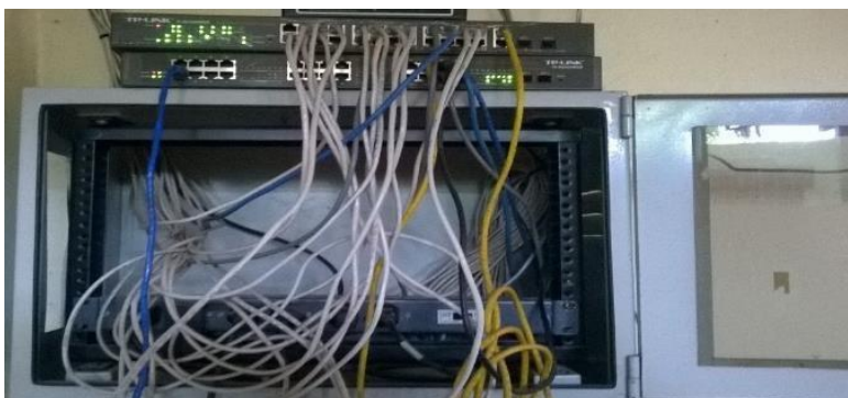
Figura 3.9 Conexiones del cableado de red de datos Fuente: Elaboración propia
