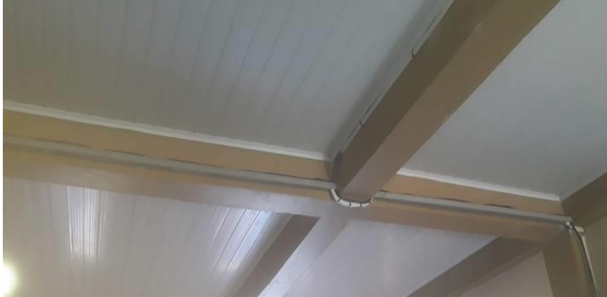
Figura 3.25 Cableado de distribución horizontal Fuente: Elaboración propia
