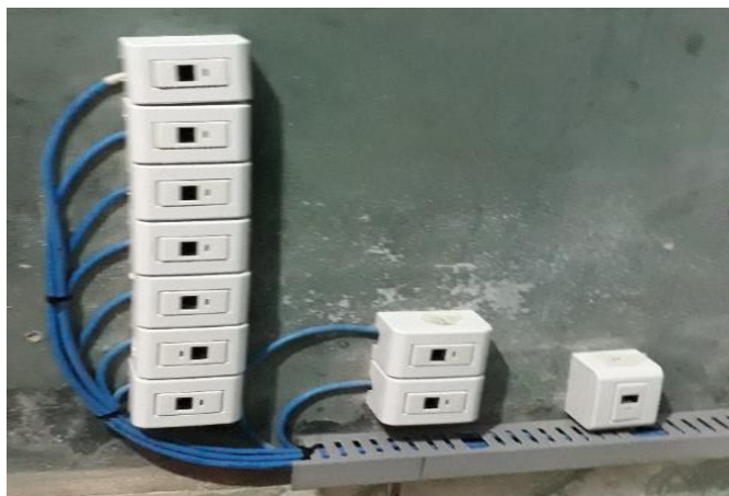
Figura 3.33 Tomas de red instalada en la sala de telecomunicación Fuente: Elaboración propia
