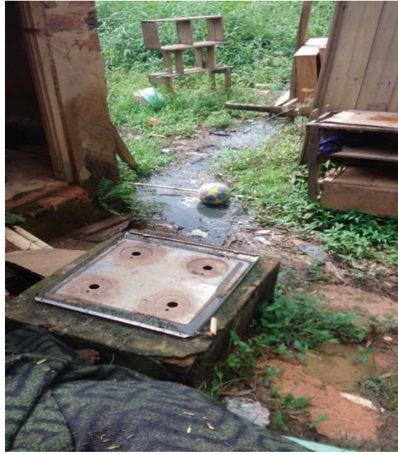
Foto N° 2 Rebalse de alcantarillado y inspección
