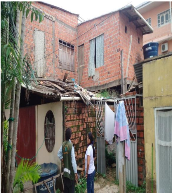
Foto N°3 Denuncias la afectación del aguas lluvia
