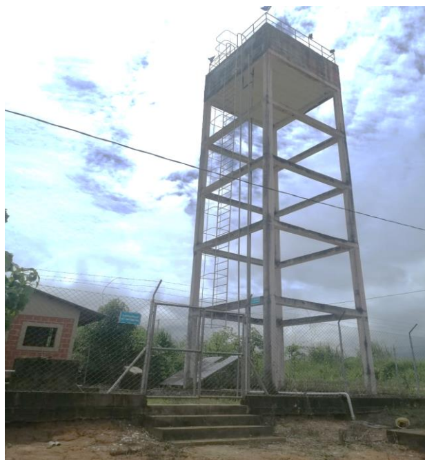
Tanque elevado en condiciones no optimas y sin mantenimiento Fotografía mediante celular- comunidad Villa Fátima
