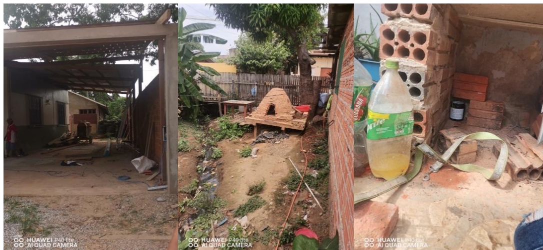
Figura 5. Acumulación de residuos y desorden en el entorno
