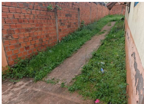
Figura 4. Residuos en pasillos y maleza
