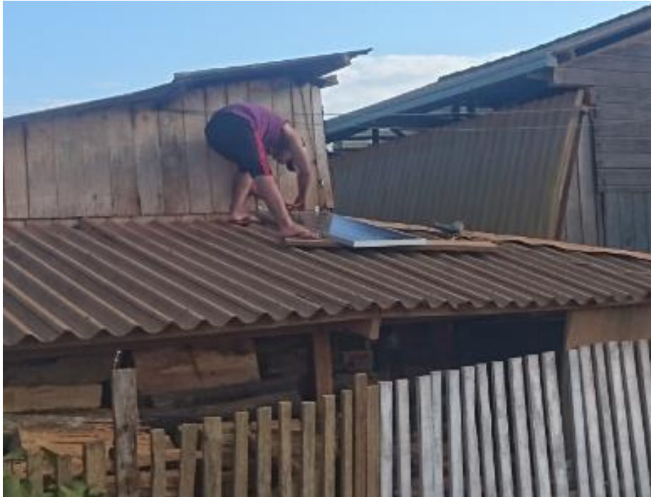
Figura 22. Estructura de soporte en el techo de la pizzería. Fuente: Elaboración propia.
