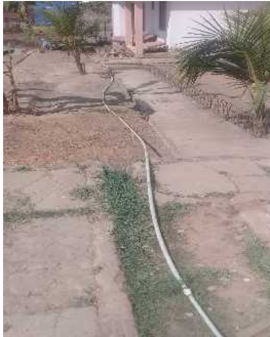
Figura 37 Las conexiones de agua para la provisión de agua diaria a los internos. Fuente: elaboración propia
