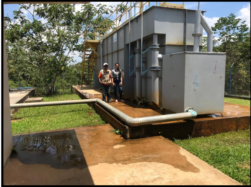
Figura 5 Anexo I. Filtros de Tratamiento de agua Planta Villa Rojas
