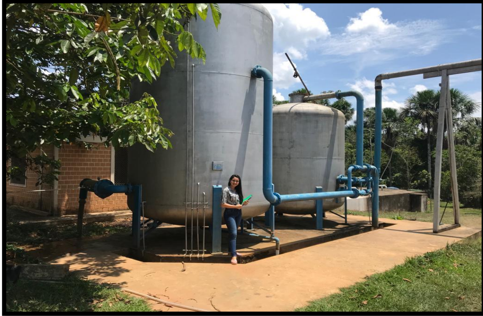
Figura 3 Anexo I. Filtros de tratamiento de agua
