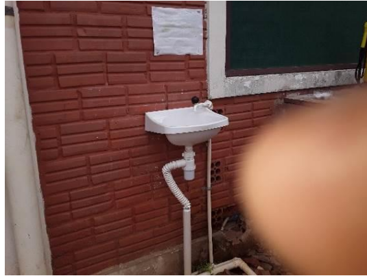
Lavamanos que se encuentra en la parte exterior de las oficinas de SEMASUR
