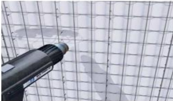
Figura 8 Contracción con fuego del poliestireno para canalización previo al proceso de revocado
