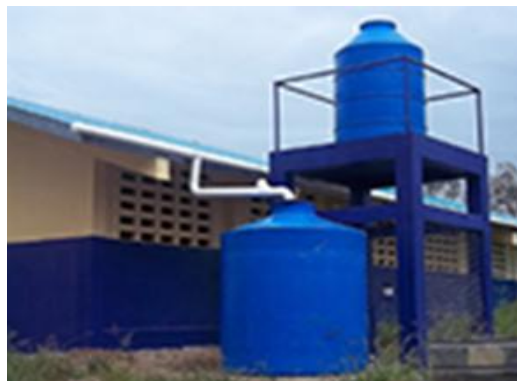
Figura 12: Tanque de agua para reservorios.
