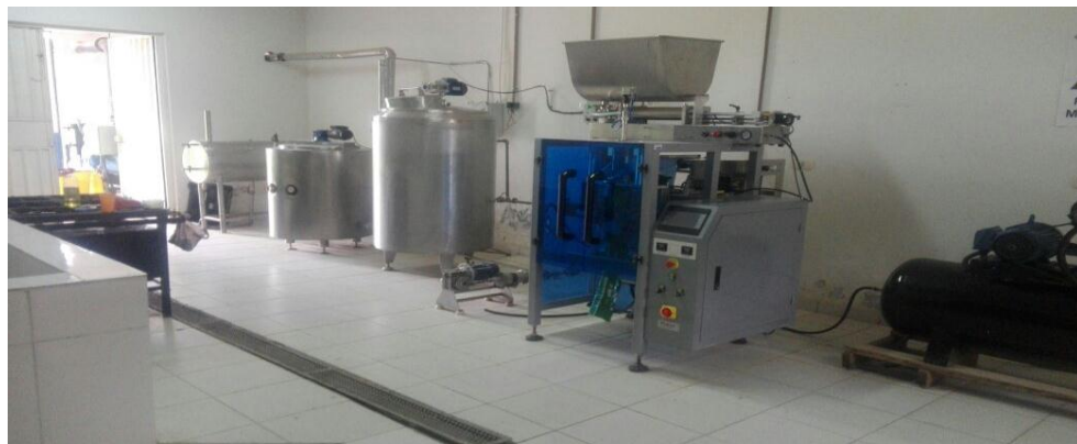
Anexo N 4: Maquinaria que existe actualmente en la línea de lácteos.
