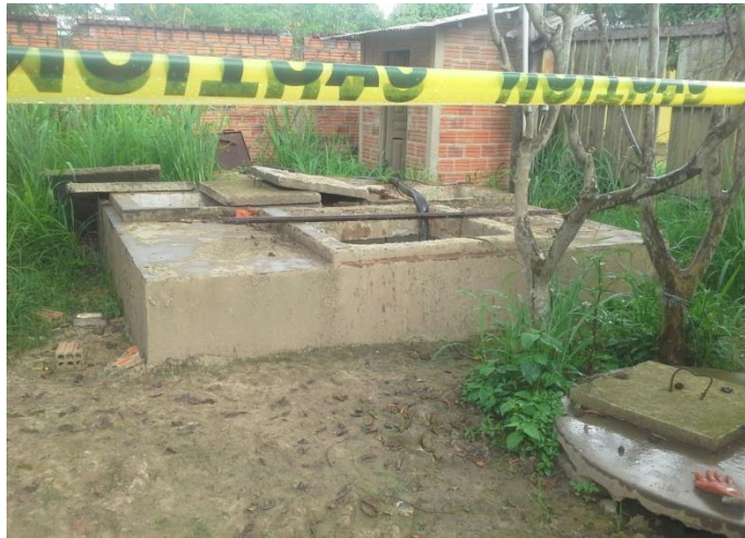
Figura N°3: Tanque imhoff en el Barrio Mapajo
